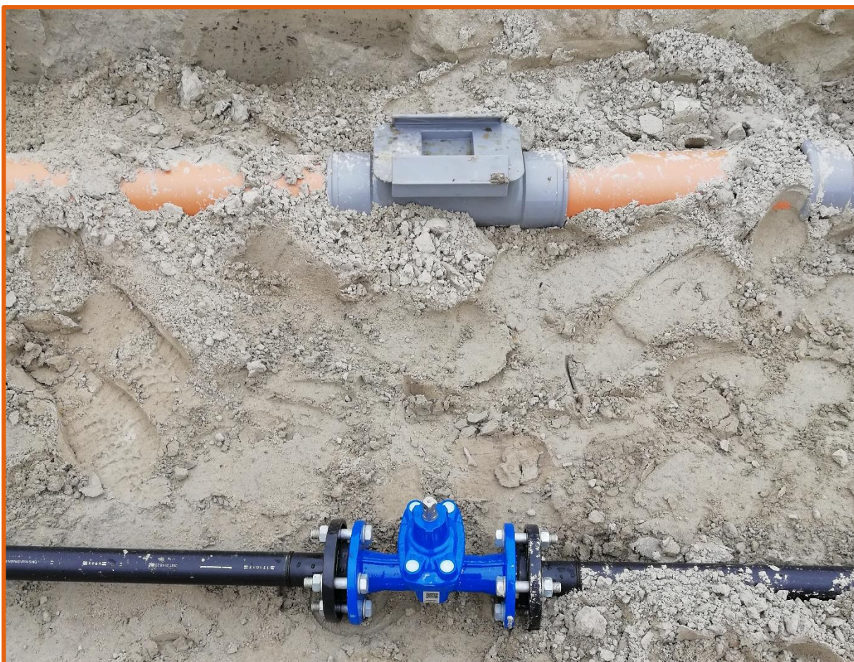
Foto 1 Ontstoppingsstuk en afsluiter
